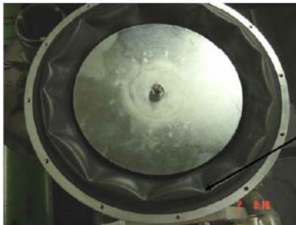
Abbildung 3-28: Gequollene Kunststoffmembran in der Gasregelstrecke der Anlage Spiez, [56]
